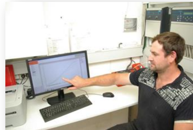
Sprawdzanie systemów pod kątem alarmów
